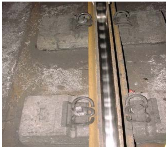
Figure 49: Usure ondulatoire sur une section de rail
